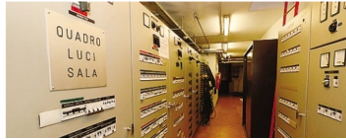
Anche la cabina elettrica sarà completamente rinnovata
